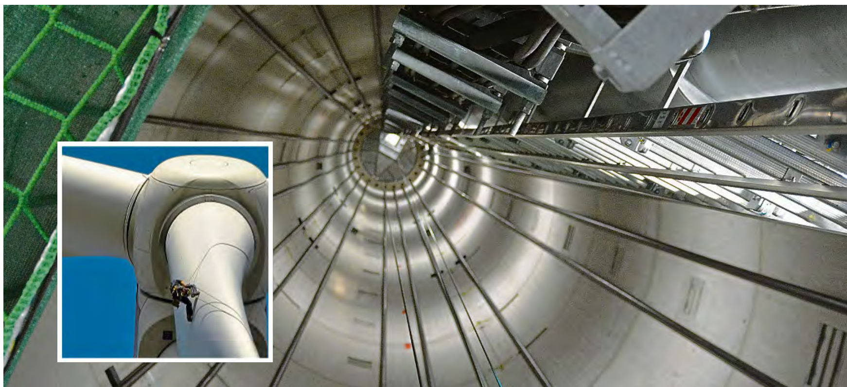
Blick in eine der acht Nordex-Windkraftanlagen in Sellen: Zum Windfest in der Burgsteinfurter Bauerschaft kamen vor allem am Sonntag zahlreiche Besucher – und sahen so spektakuläre Bilder wie die Inspektion einer Mühle von außen (kl. Bild). Fotos: R. Schippers (4), G. Hilgemann (1)
